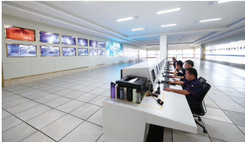
重庆三磊玻纤股份有限公司窑炉DCS自动控制系统
