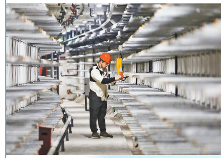
10月25日,巴南区地下综合管廊内,技术人员正在对检测设备进行调试。
