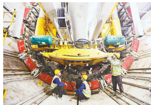
10月30日,轨道交通27号线长江隧道始发井,技术人员正在进行盾构机始发前的检查工作。
