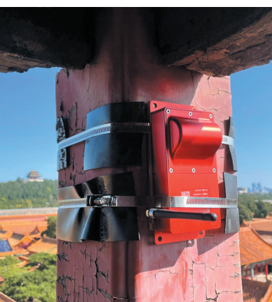
振动倾斜监测终端应用在故宫雨花阁顶层角柱
