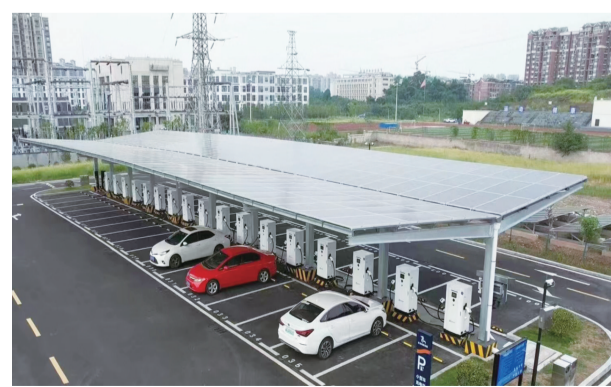
铜梁北环路光储充检换一体站
