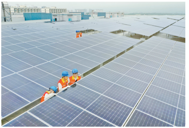
近日，重庆璧山综合智慧零碳电厂比迪光储能项目，运维人员正在巡查。 记者 张锦辉 摄/视觉重庆
