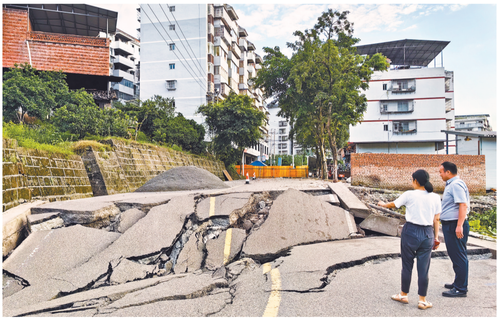
7月5日,云阳高阳镇青树村猫耳洞滑坡点,工作人员正在查看省道S202路面破损情况。 首席记者 陈维灯 摄/视觉重庆
