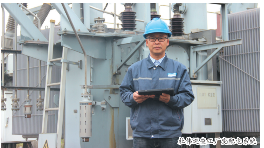
杜伟巡查工厂变配电系统
