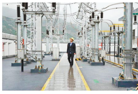
奉节变电所,值班员陈书斌正在巡查设备。
