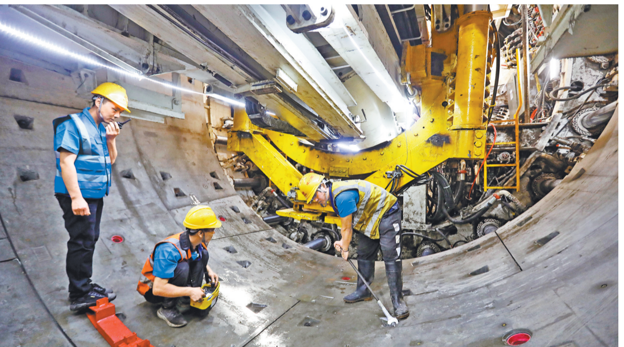
四月十二日，二十四号线一期工程首台TBM在茶涪路站顺利始发。图为技术人员正在TBM前端进行管片拼装。记者 罗斌 摄(视觉重庆)
