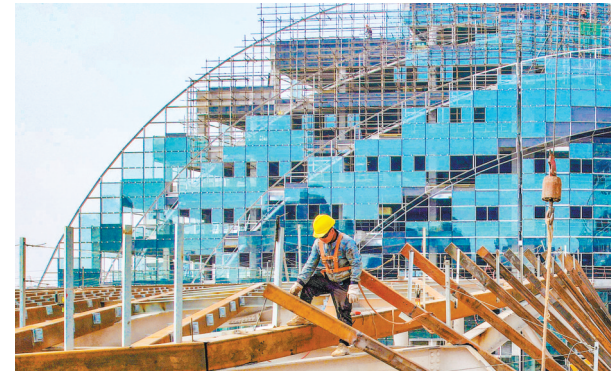
三月十五日，西部（重庆）科学城科学谷一期项目现场，中建七局施工人员正在进行钢架焊接作业。首席记者 龙帆 摄/视觉重庆
