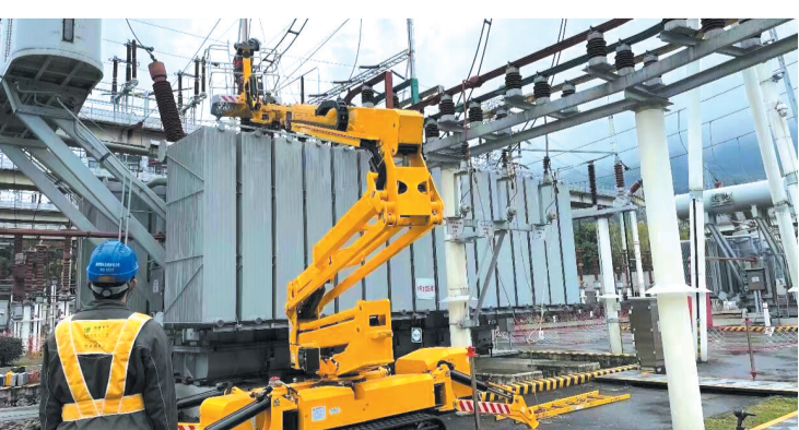
国网北碚供电公司新型作业平台助力变电设备“春检”
