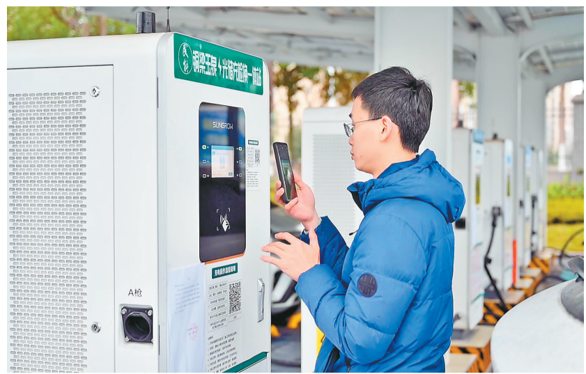
铜梁玉泉光伏充换检一体化站项目，市民正在扫码为汽车充电。 记者 周奇 摄/视觉重庆
