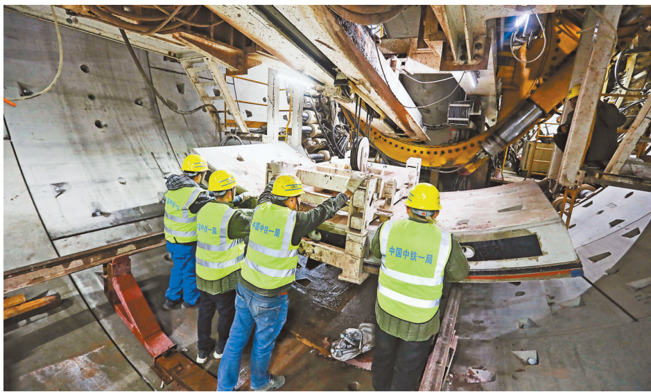
重庆城轨快线15号线一期绣湖路车站,中国中铁的技术工人正在TBM掘进机内进行管片拼装。(摄于1月28日) 记者 罗斌 摄/视觉重庆
