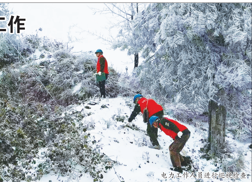
电力工作人员进行巡视检查。
