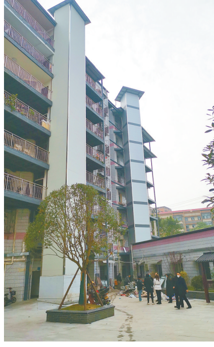
1月14日,铜梁巴川街道东方社区云龙巷19号2栋3单元,加装的电梯即将完工并交付使用。 记者 陈维灯 摄/视觉重庆
