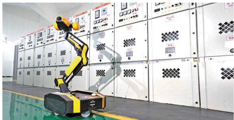
重庆建成首个“零停电”感知示范区 摄/郭旭
