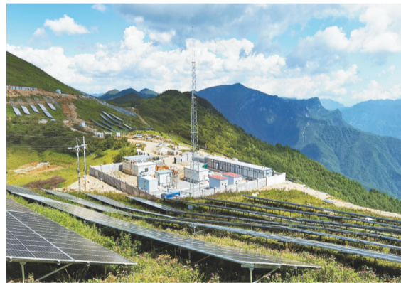
城口县咸宜镇的光伏项目一期，该项目是城口大巴山新能源基地项目的重要组成部分。（市发展改革委供图）
