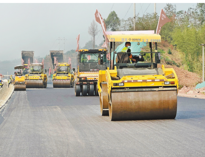
十二月四日,合璧津高速公路前期通车路段,中铁十二局施工工人正在进行沥青摊铺施工。该段全长约四十三公里,起于合川十塘,止于璧山七塘,预计年底通车。记者 罗斌 摄/视觉重庆
