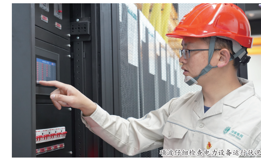
项波仔细检查电力设备运行状况
