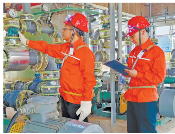
工人正在生产现场巡检
