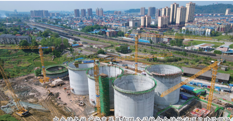
中央储备粮广安直属库有限公司粮食仓储物流项目建设现场
