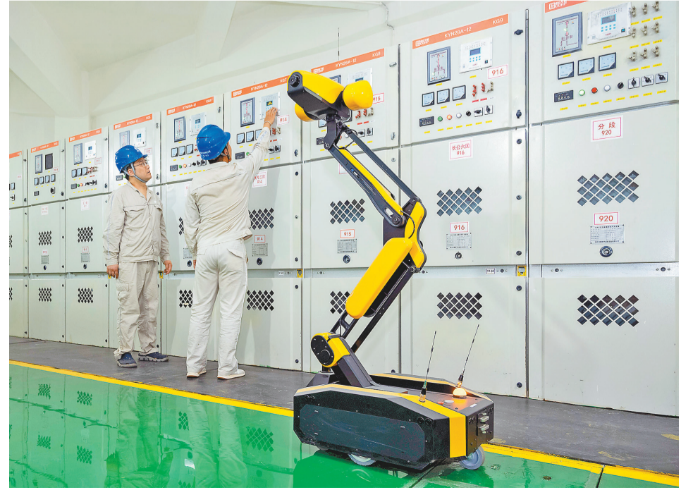
8月8日，南岸区长嘉汇10千伏开闭所内，自动巡检机器人和运维人员正在作业。记者 张锦辉 摄/视觉重庆
