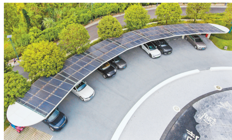
▲两江新区悦来美术馆停车场，车辆在光伏充电站充电。该光伏充电站全年发电约15万度，能满足这里14个充电位的用电需求。(摄于7月3日) 记者 张锦辉 摄/视觉重庆
