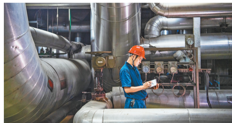
江津华能珞璜电厂，碳排放管理员正在设备前落实碳排放相关数据，确保数据准确。(摄于4月27日) 记者 郑宇 摄/视觉重庆
