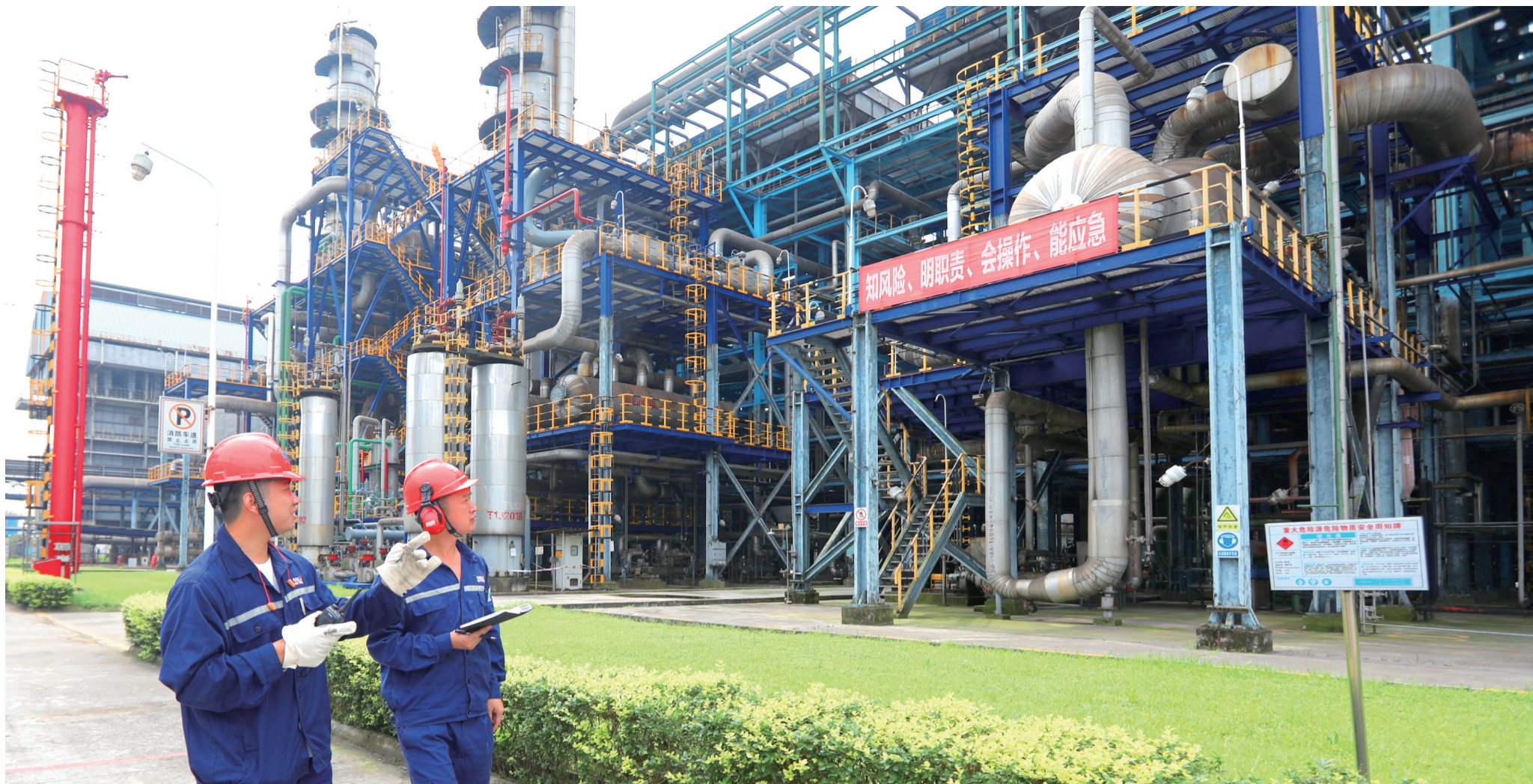
现场精馏系统巡检
