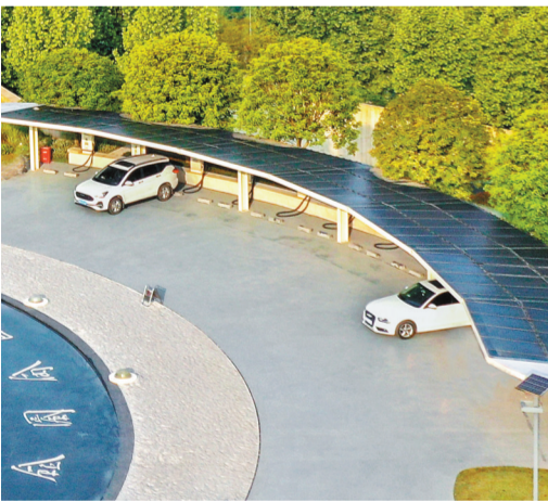
4月7日，两江新区悦来美术馆停车场，光伏充电站顶部的光伏发电板。
