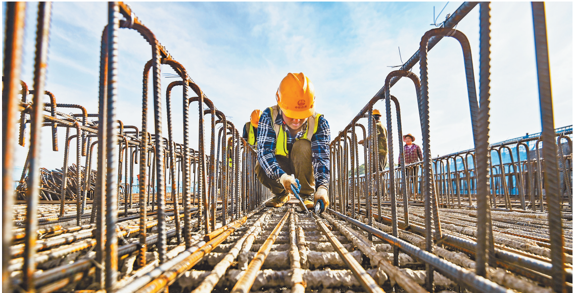
西部(重庆)科学城科学大道一期,狮子立交西半幅道连续梁作业现场,工人正在加紧施工(摄于五月四日)。首席记者 龙帆 摄影 视觉重庆
