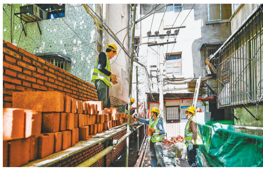
4月21日,渝中区朝天门批发市场附近,施工人员在老旧小区排水管网、化粪池等进行改造。据了解,该区计划今年新建城市排水管网6.6公里,分流改造1.2公里,进一步提升城市品质,不断增加市民获得感、幸福感、安全感。
