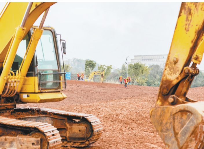
2月7日,西部(重庆)科学城高新大道,工人正抓紧施工。首席记者 龙帆 摄/视觉重庆
