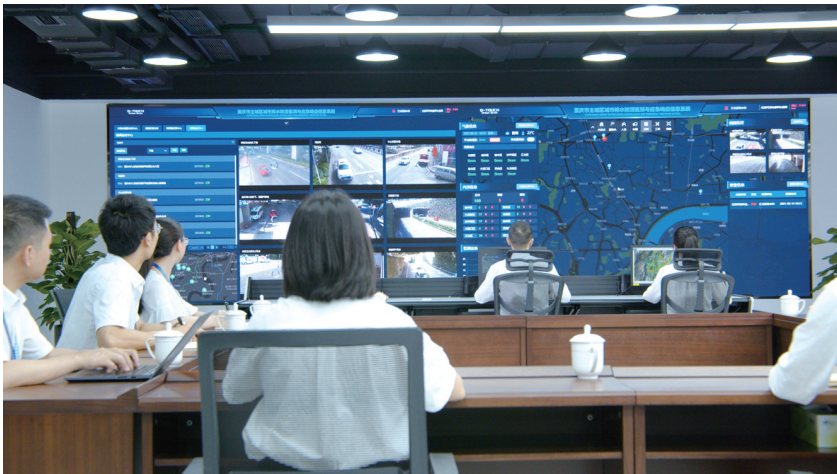
工作人员监控城市排水防涝检测与应急响应信息系统
