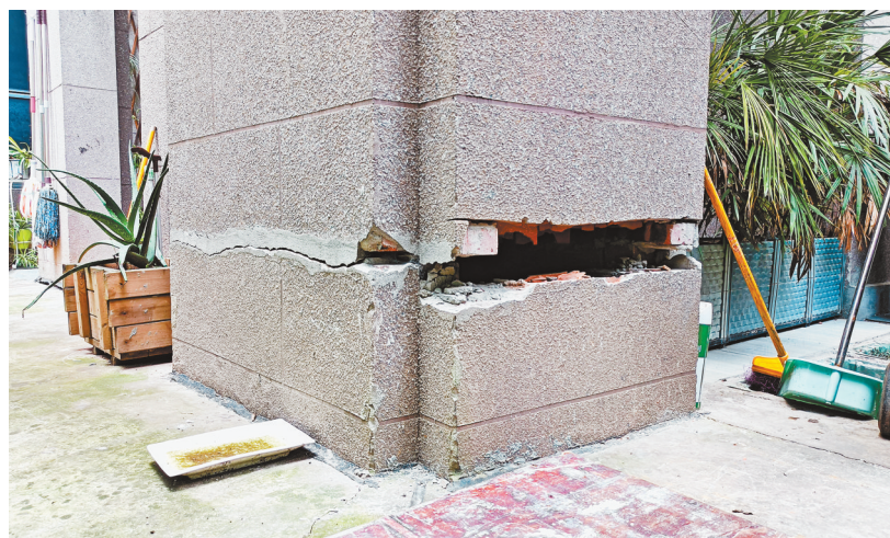
宏帆路某小区内,1栋大门左侧墙面开裂。 记者 崔曜 摄/视觉重庆
