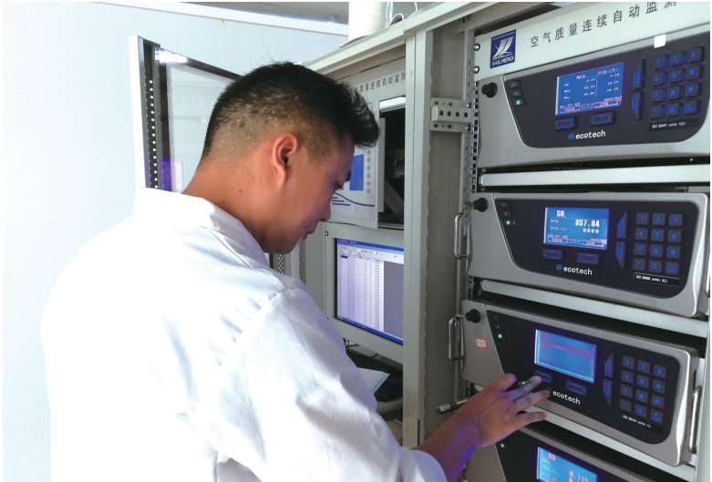
空气质量自动监测站点内工作人员开展设备维护
