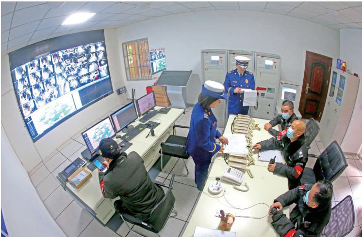
智慧安全消防中控室焕然一新,消防指战员定期到此检查消防智慧系统运转情况,让小区居民住得更加安心 摄/钟志兵 视觉重庆
