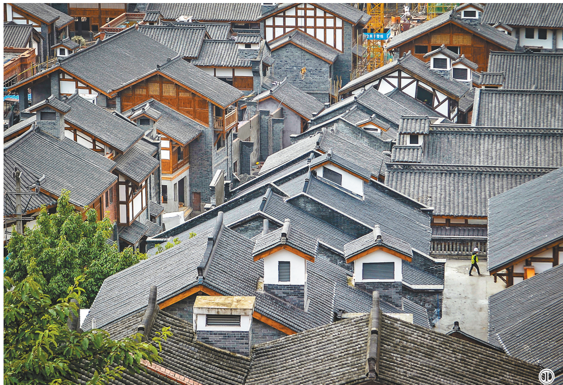
图①:9月18日,渝中区十八梯核心区主体建筑基本完工。 图②③:9月18日,渝中区十八梯,工作人员正在向商家介绍十八梯项目情况。
