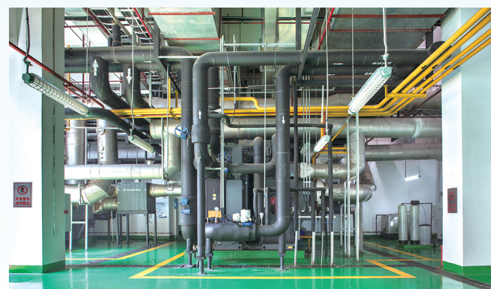
江北城江水热源热泵集中供冷供热项目
