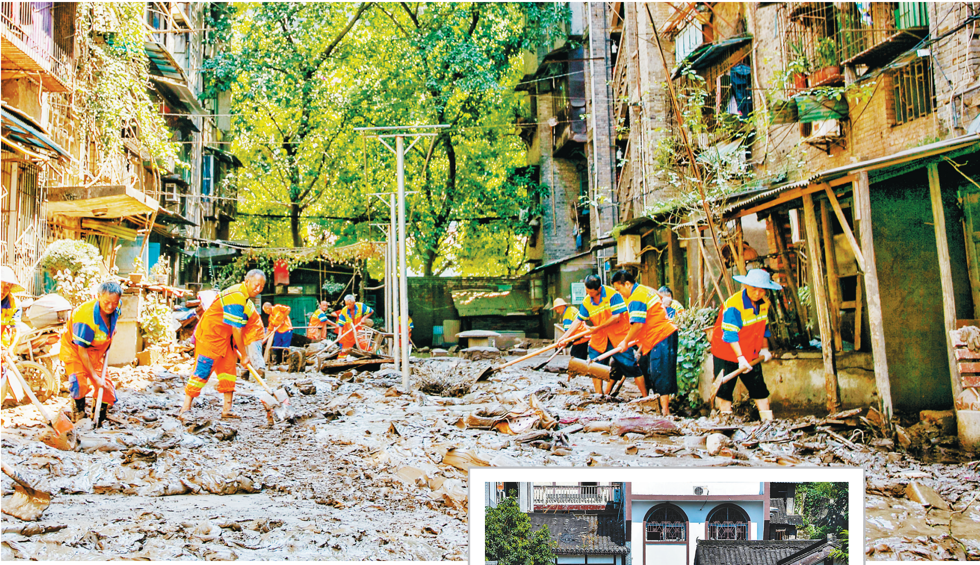
▲8月23日,江北区郭家沱,环卫工人正在清理居民小区路面的淤泥。 通讯员 曹检 摄/视觉重庆
