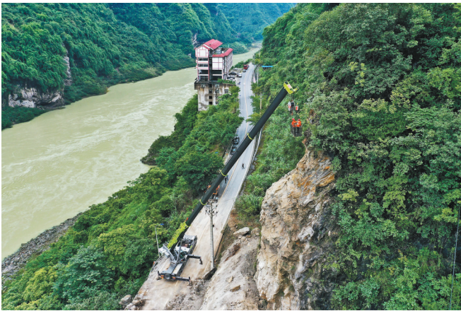
现场。国道211线彭水苗族土家族自治县汉葭街道沙沱社区与万足镇小河村交界处公路边坡处险情排除。
