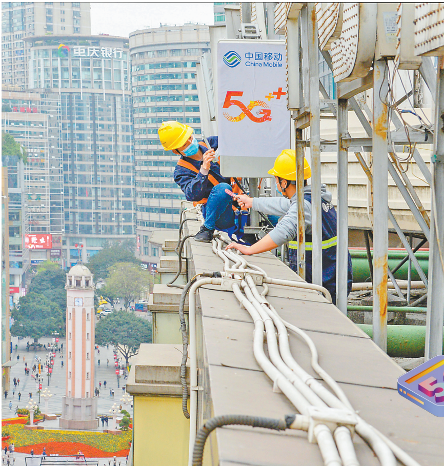
4月9日，中国移动重庆公司工作人员正在对5G基站进行调试。
